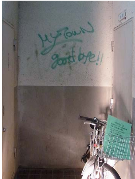
写真4 引っ越した子どもが廊下の壁に残した落書き
