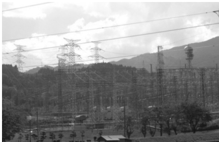
[小学校近隣の変電施設]
