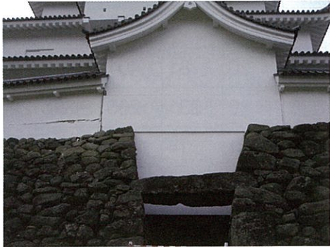
亀裂の入った漆喰壁
