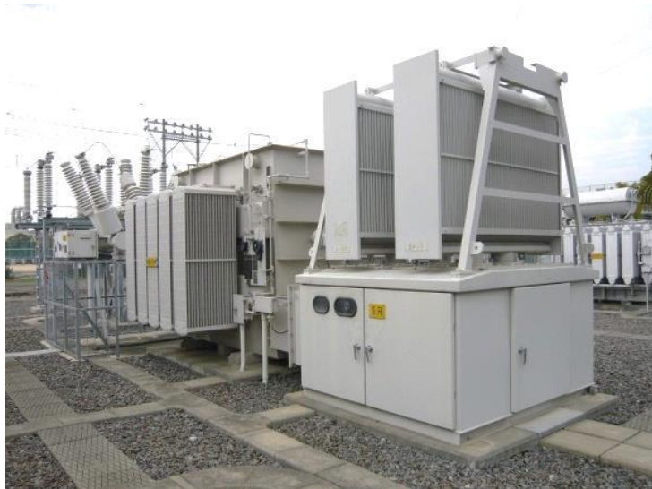
図 2.4 直列 12 パルスシリコン整流器と整流器用変圧器 (1500V, 6000kW, 沸騰冷却式)
