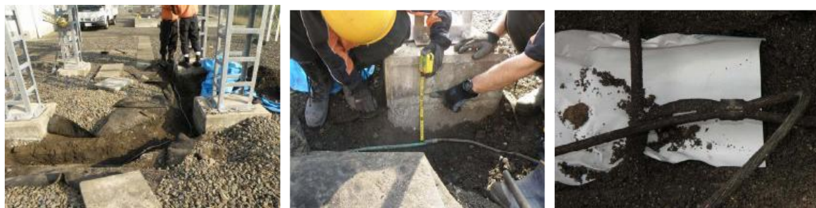
図 3.7 埋設された接地網の状態
